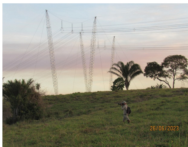
Figura 2 - Realização de avistamento e registro fotográfico da avifauna, durante as amostragens quali-quantitativas nas imediações das torres e do cabeamento da linha de transmissão.
