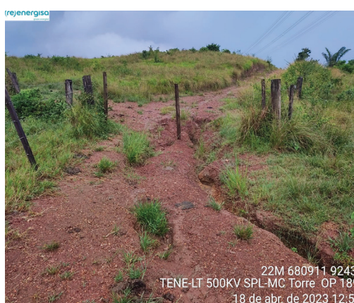
Figura 2 Registro de desvios / deficiências de drenagem
