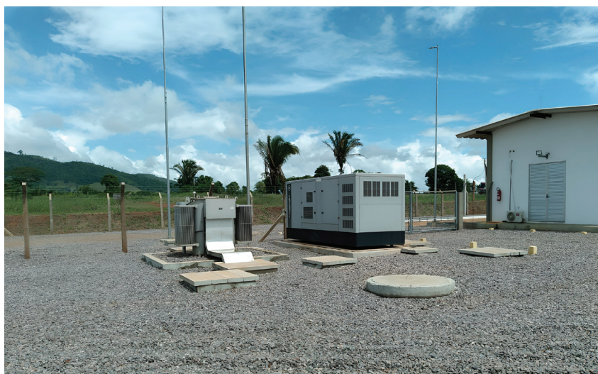
Figura 9 – Caixa de passagens e sumidouro na SE Serra Pelada.
