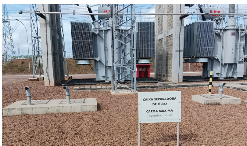
Figura 8 - Caixa Separadora de Água e óleo (CSAO) na SE Xingu
