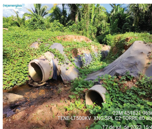
Figura 5 Registro de desvios / bueiro danificado
