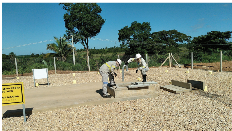
Figura 6 - Caixa Separadora de Água e óleo (CSAO) na SE Miracena-TO
