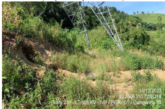
Figura 1.3.13. Paliçada com danos estruturais, porém sem interferência na estrutura da torre (Torre 231).
