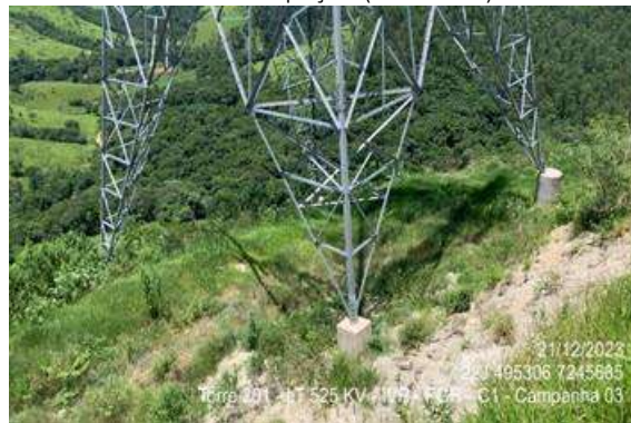
Figura 1.3.5. Cobertura vegetal sem avanços satisfatórios em pontos arenosos da área, porém sem interferência na estrutura da torre (Torre 201).
