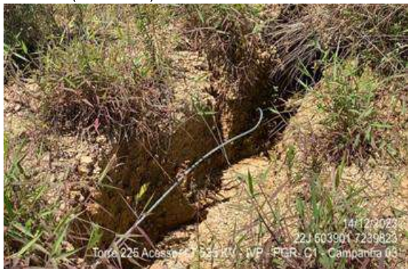
Figura 1.3.12. Processo erosivo descobriu cabo de aterramento (Acesso 225).
