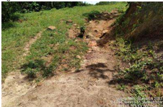
Figura 1.2.3. Processos erosivos pontuais nos acessos às torres 121 e 122.
