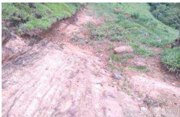
Figura 1.2.1. Princípio de processos erosivos na área da torre 93.
