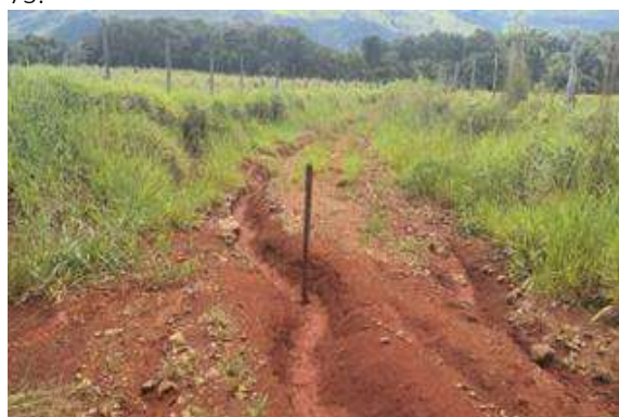
Figura 1.2.6. Processos erosivos acesso à torre 111.
