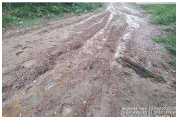
Figura 1.2.2. Princípio de processos erosivos ao longo do acesso à torre 92.
