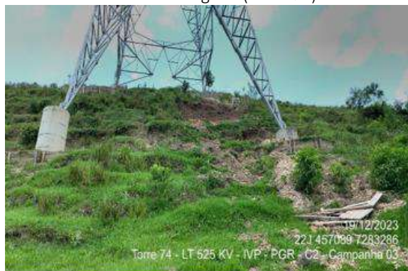
Figura 1.3.4. Princípio de deslizamento maciço com danos a paliçada (Torre 74).
