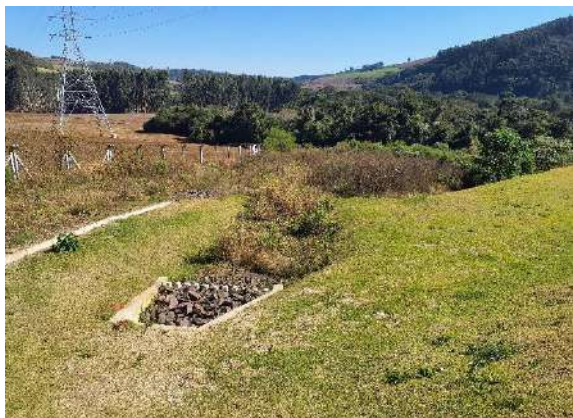
Figura 1.3.6. Vista do dissipador de energia implantado na área AA 0002.
