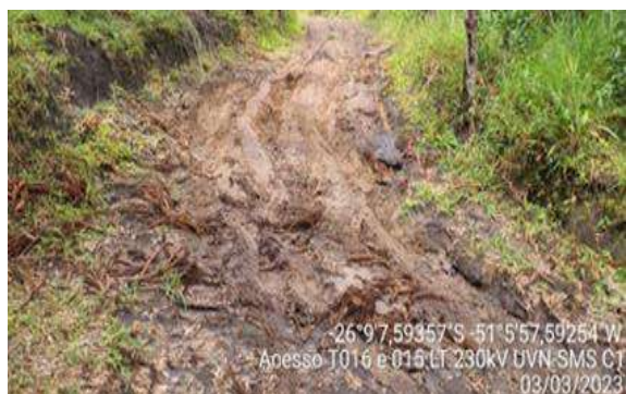
Figura 1.2.1. Princípio de processos erosivos em acessos às torres 15 e 16.
